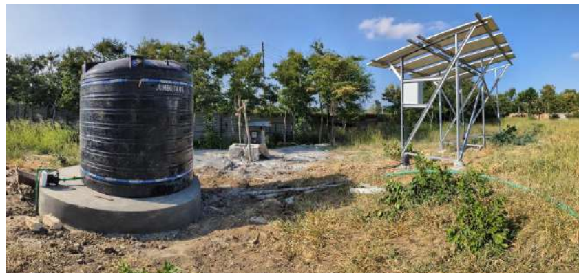
ハイブリッド化後の井戸設備全景（水タンク・ソーラーパネル・配管）
