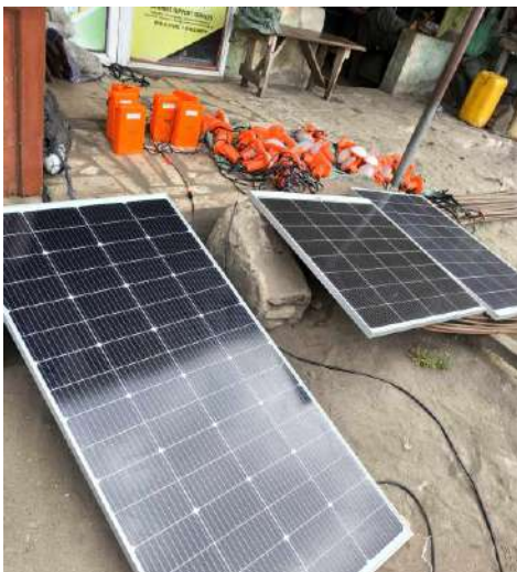
太陽光パネルとバッテリー
